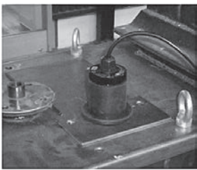
図-2 コンベヤに設置した熱源検知器
