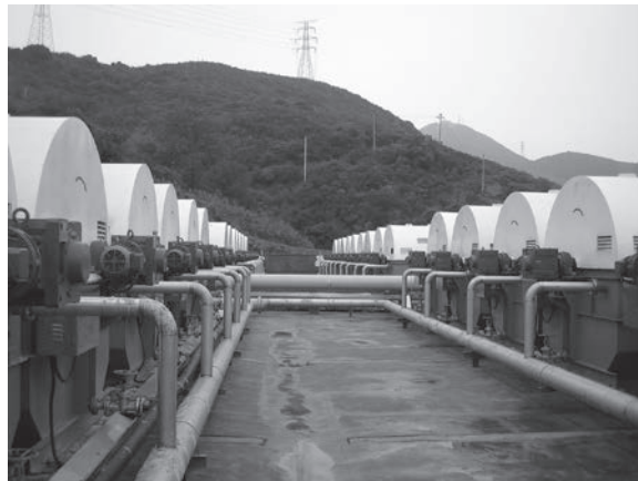
写真-3 納入実績：中国杭州市3000m 3 /日
