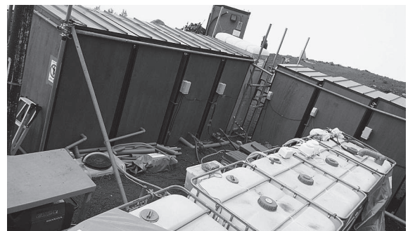
背面水処理装置
