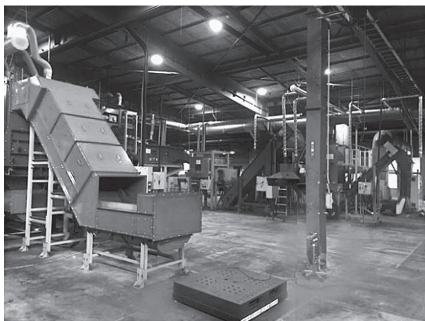
図-3 松田産業(株) 破碎・選別設備の外観
