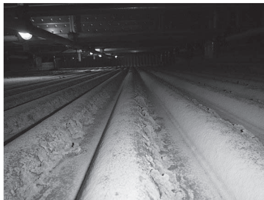
写真-4 放射室 (SCS導入後, 200日間操業)
