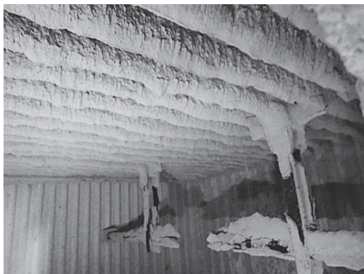
写真-5 過熱器 (SPS導入前, 100日間操業)
