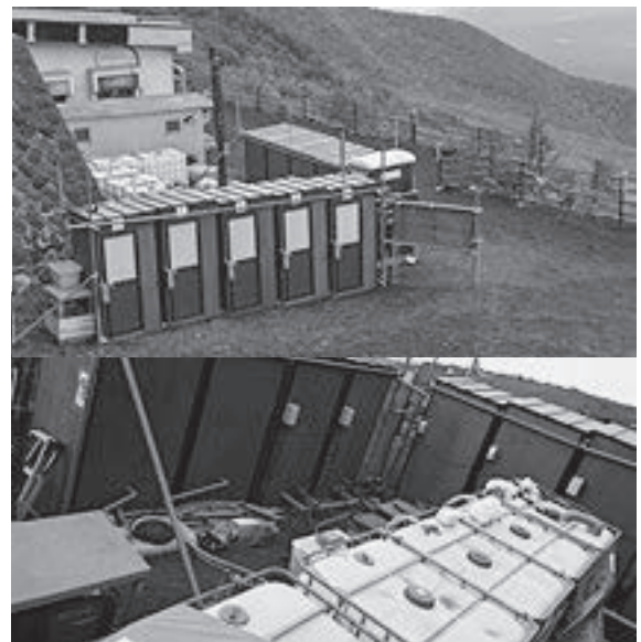
富士山6号目設置状況
