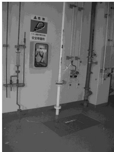
写真13 事故があった汚泥貯留槽
