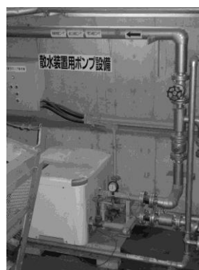
写真6 スプリンクラー用ポンプ
