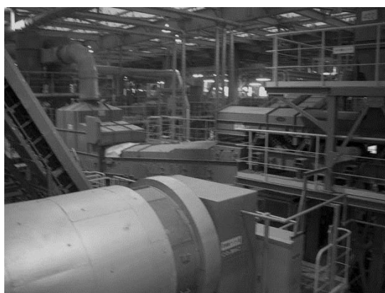
写真２２ 工場内全体、奥に破碎処理後の手選別の精選別ラインが望める 手前 GANGウェイ、工具などが落ちないように手すりの下部にバーが見える。
