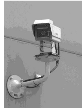
写真8 屋上に取り付けられた 煙監視用カメラ
