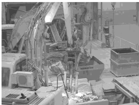
写真２０ 建設廃材機械選別ヤード
