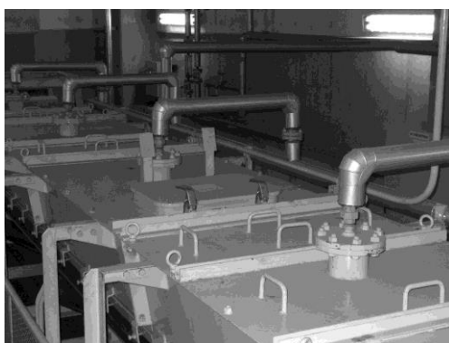
写真5 火災センサーとスプリンクラを取り付けたコンベア
