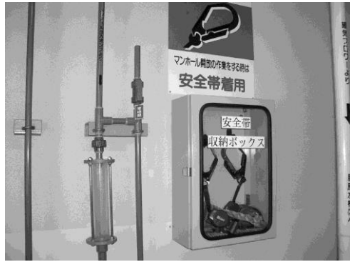
写真 15 事故現場直近の安全帯置き場
