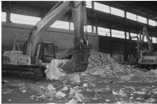
写真23 廃プラスチック受入ヤード
