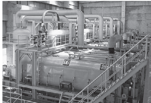
図-2 汚泥乾燥機(MSD-240×4台)の外観写真
