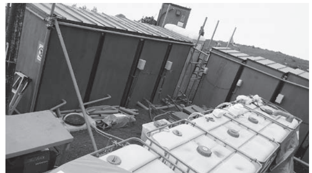
右下タンクが排水処理装置
