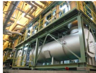
福島市・堀河町終末処理場 下水汚泥仮設減容化施設
