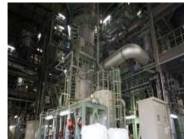
福島県県中浄化センター(郡山市)における下水汚泥焼却事業
